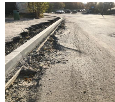
ул. Траловая (2021 г., по контр. 31.08.21, фото 23.09.21)
